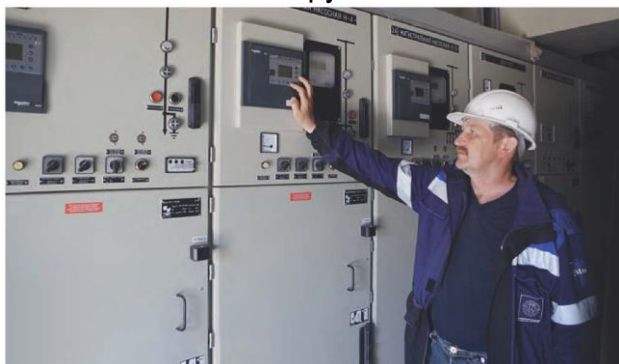
Инженер-энергетик Новосибирского РУ ОАО «МН «Дружба» Юзеф Ситдигов проверяет оборудование на НПС № 7
