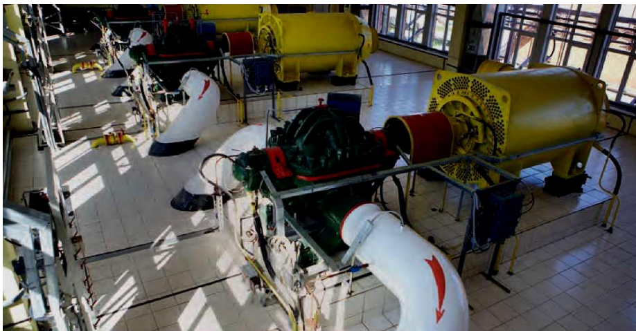
Магистральная насосная на ЛПДС «Унеча»
